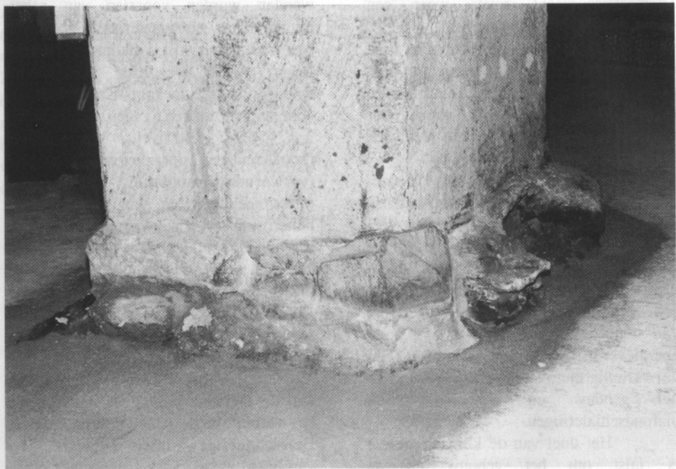
Pijler in Kapel; rond het fundament is geen beton gestort, maar zand afgewerkt met mortel (Foto: J. Schreuder)
